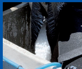
Trägermaterial Einfüllen der Aufwuchskörper in den Behälter.
